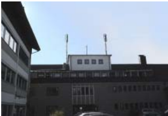
D-Netz Mobilfunkmast auf einem Betriebsgebäude
